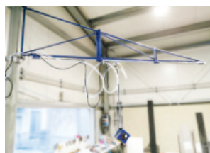
Die Zuführung am Schwenkarm erleichtert das Arbeiten und schützt Kabel und Schläuche.
